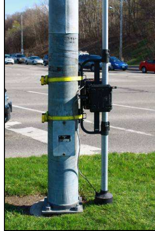
Figura 10 unità di rilevamento posizionata a terra
